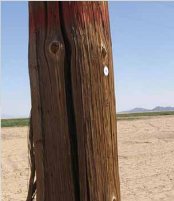
Poste de madera de 115-kV quebrado al Sur de Phoenix Crédito: Western Area Power Administration FY2011 Ten Year Capital Program Meeting PowerPoint
