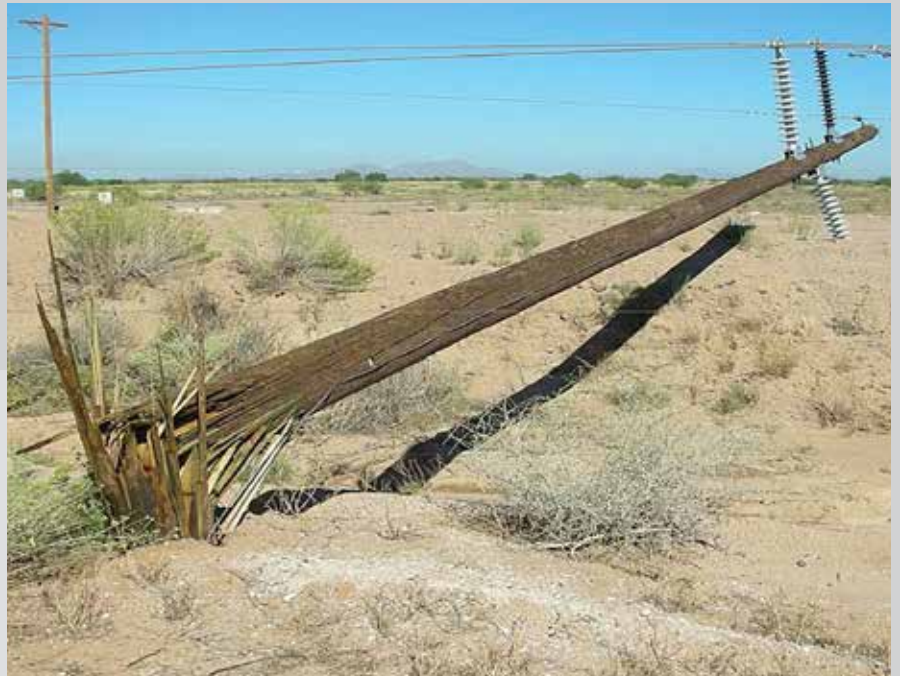
Daño en línea de transmisión causado por una tormenta Crédito: Western Area Power Administration FY2011 Ten Year Capital Program PowerPoint*
